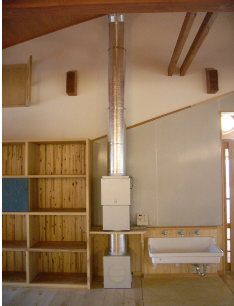
■ 保育室のパッシブソーラーシステム
